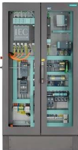
Gráfico 6-18 Panel de control con gabinete adecuado
