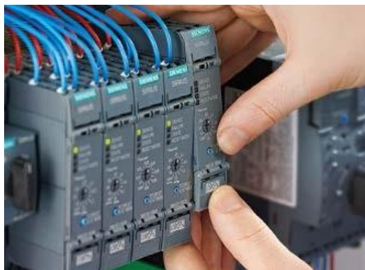
Gráfico 7-10 Arrancadores de motor SIRIUS 3RM1 en el panel de control
