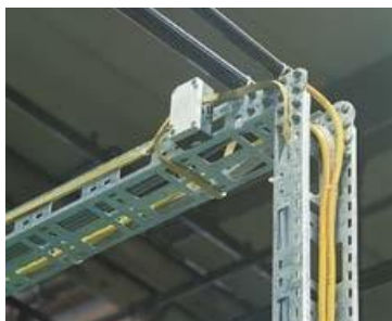
Gráfico 6-24 Cable instalado libremente en un rack de cable
