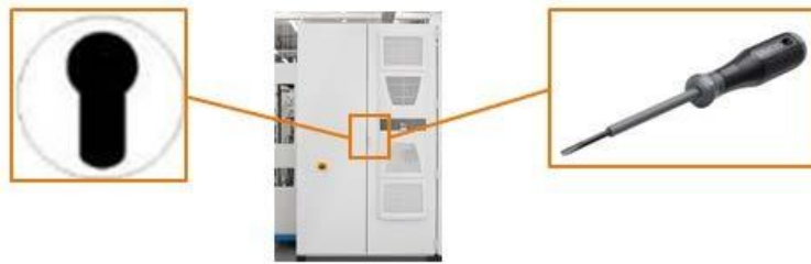
Gráfico 6-19 Panel de control bloqueado por medio de una llave o por conexiones de tornillo
